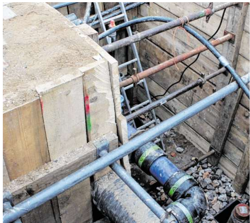
Die Armatur (blau-schwarzes Rohr) wurde ausgebaut und soll mikrobiologisch untersucht werden, um die Ursache für die Wasserverschmutzung herauszufinden. BILD: KTS
